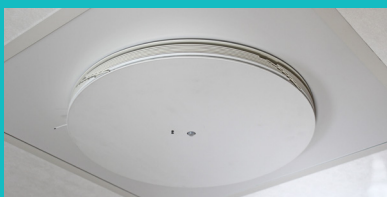
Det aktiva taktilluftsdonet TTC-250 eller TTC-400 med integrerad spjällmotor, regulator och givare. Systemet medger variabelt luftflöde från enskilda don.
