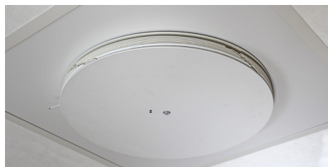
Ett aktivt taktilluftsdon monterat med undertaksplåt UTD i undertakets bärverk.
